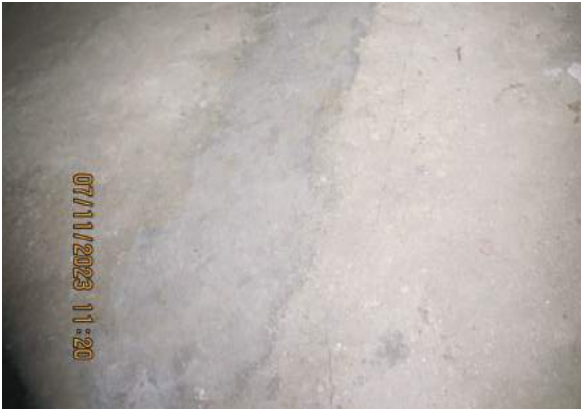
Dettaglio lesioni: fessurazione comparsa in adiacenza alla sigillatura del 2006
